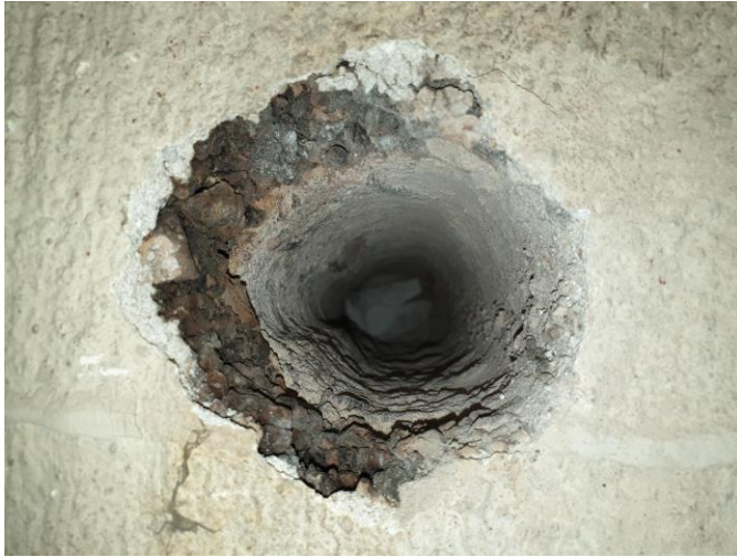
Bild 2: Vid rivning - Sett inifrån – ett genomgående hål i ytterväggen.
